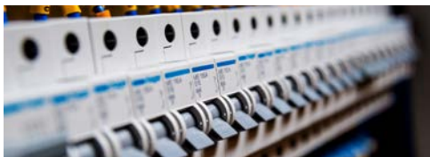
ONGARI IMPIANTI ELETTRICI
